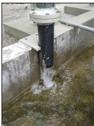
Imagem 9: Clarificado do adensador.
