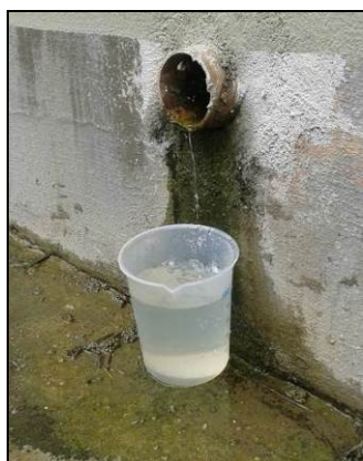
Imagem 8: Clarificado do leito de secagem.
