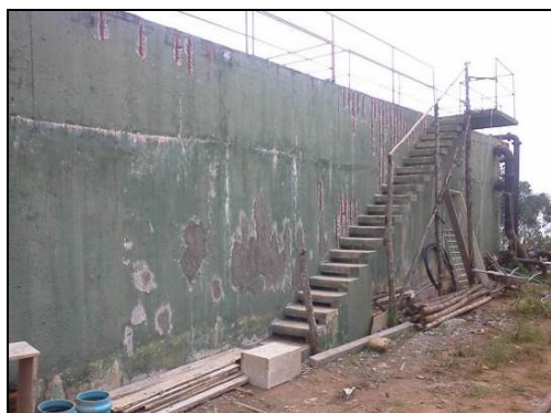
Imagem 1: Estado dos filtros lentos quando da doação do SAA (2010).
